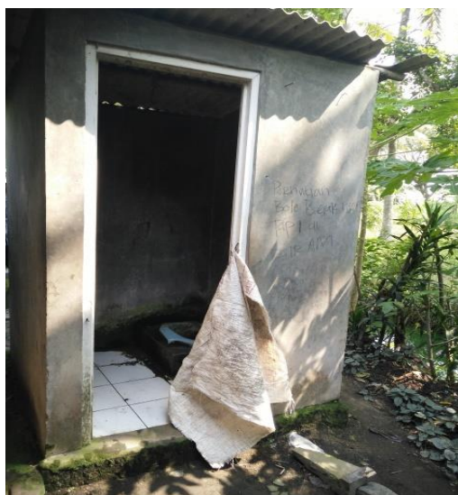
Gambar 4.16:MCK sebelum direnovasi
