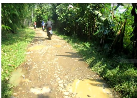
Gambar 3. 7 : Kondisi Jalan Menuju SDN 03 Curug dan SMPN 01 Atap
