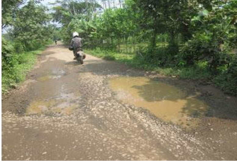
Gambar 0.5: Kondisi Jalan Desa Rancabuaya
